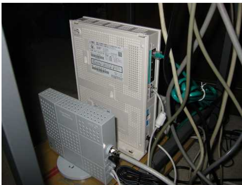
右 = 上から LAN ケーブル、光電話線、光ファイバー 左 = 上から TV 同軸ケーブル、光ファイバー、光ファイバー (両方の装置を光ファイバーで連結 = 電話ノイズ対策)
